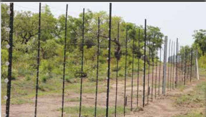
Ligne de clôture érigée dans la zone d'occupation contrôlée du Parc national de la Pendjari pour limiter les conflits homme/faune
